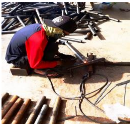
Gambar 6. Kondisi lingkungan pekerja sebelum perbaikan
